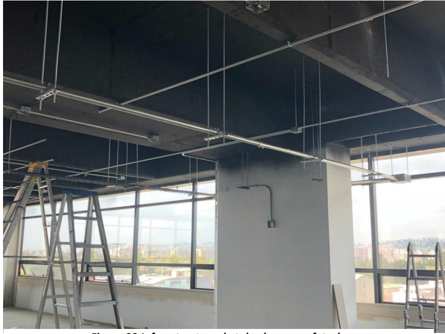
Figura 22. Infraestructura de tubería zona cafetería
