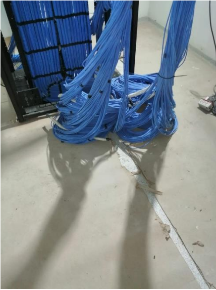
Figura 44. Llegada de cableado a los racks
