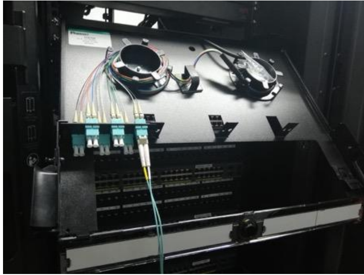
Figura 42.Llegada a de fibra a racks
