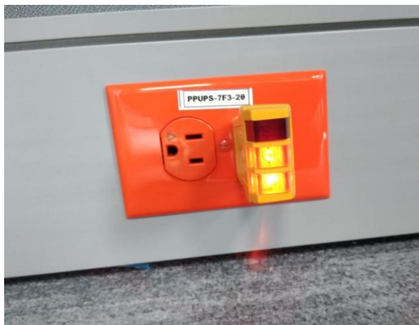
Figura 49.Prueba en toma reguladas
