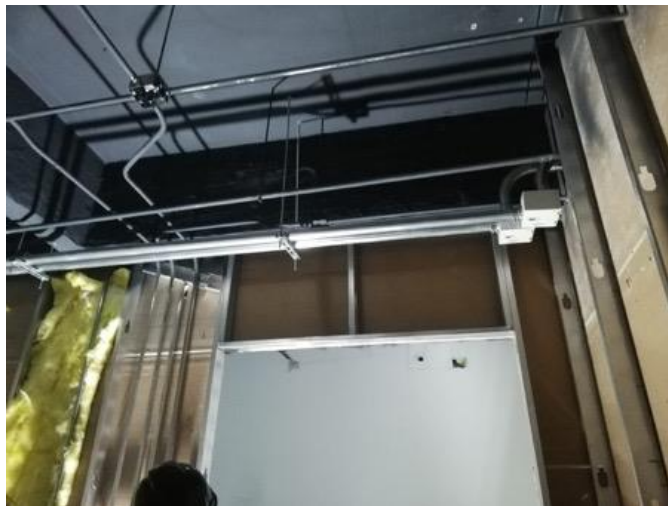
Figura 41. Infraestructura para Backbone
