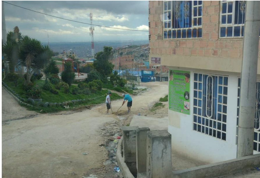
Imagen 2. Quevedo, L (2022). Vias en mal estado. Fotografía registro diario de campo
