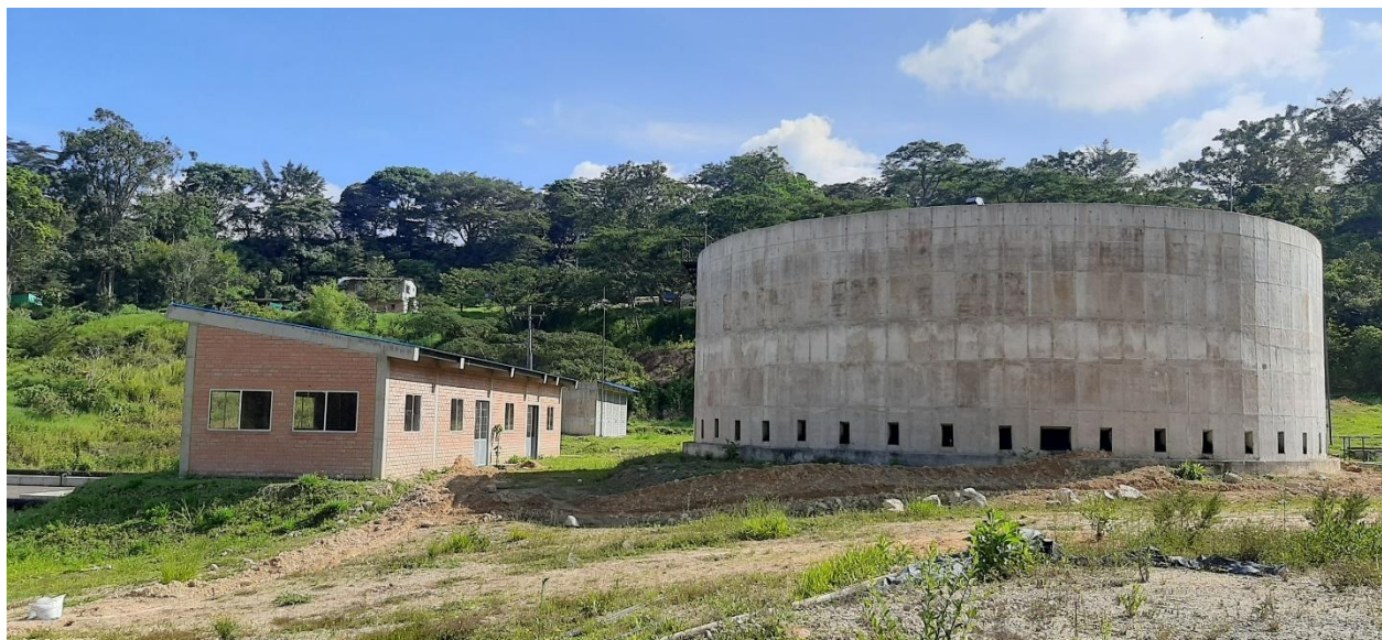
Ilustración 9. PTAR de Fusagasugá tanque perforador
