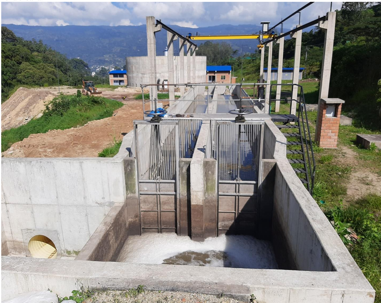
Ilustración 11. Instalaciones de la PTAR de Fusagasugá
