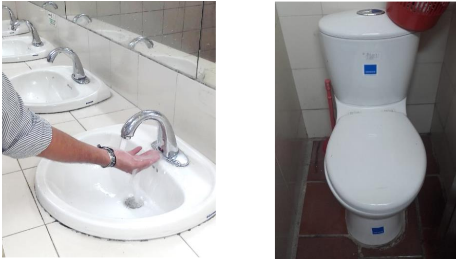
Figura 6. Dispositivos ahorradores de agua - lavamanos con sensor de movimiento y sanitario sistema push
