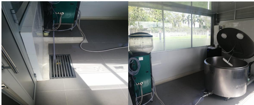
Anexo 3. Cuarto de máquinas para suministro de leche al alimentador automático Calf Feeder.
