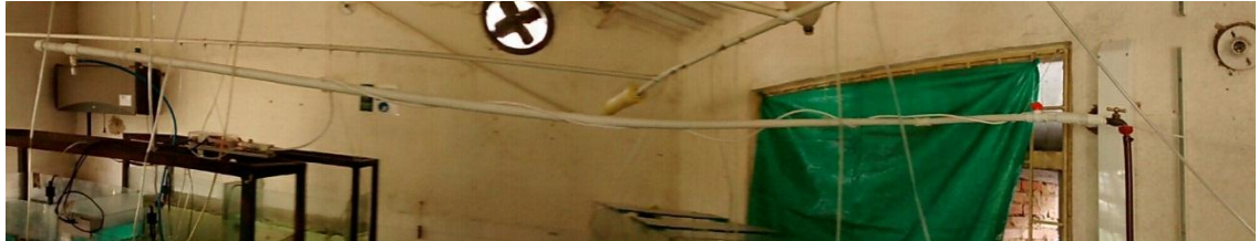
Figura 19 Conducto de agua tanque de reserva –acuario
