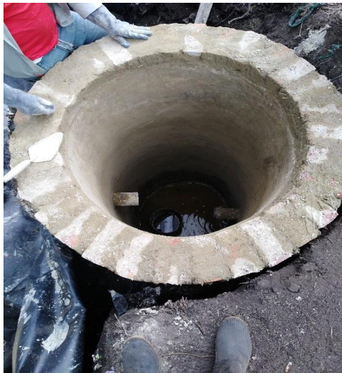
Ilustración 19 Tanques de inspección
