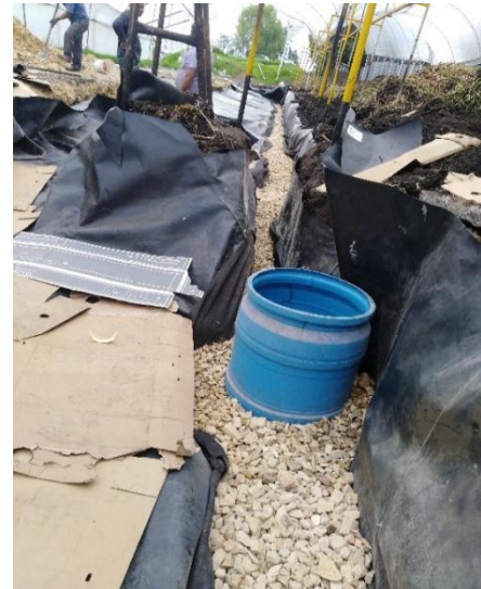
Ilustración 20 Tanques de inspección + filtros
