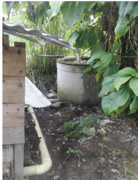
Figura 34 Recolección aguas residuales. El tanque almacena aguas residuales, no posee fugas, se recomendó al propietario enterrar el tanque.
