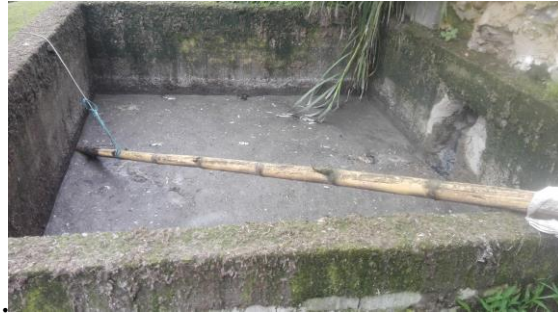
Figura 33 Tanque destapado generados de olores, además posee fugas que vierten a potrero aledaño.
