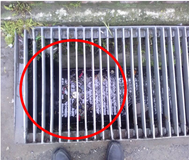
Imagen 4: Alcantarillas colmatadas por residuos
