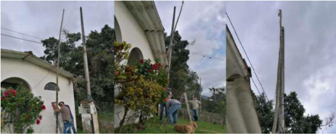
Figura N° 39: Instalación nodo Comunidad Doña Lucero (Autor).
