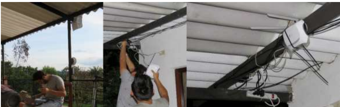
Figura N° 43: Instalación estación y Router Comunidad Don Manuel (Autor).
