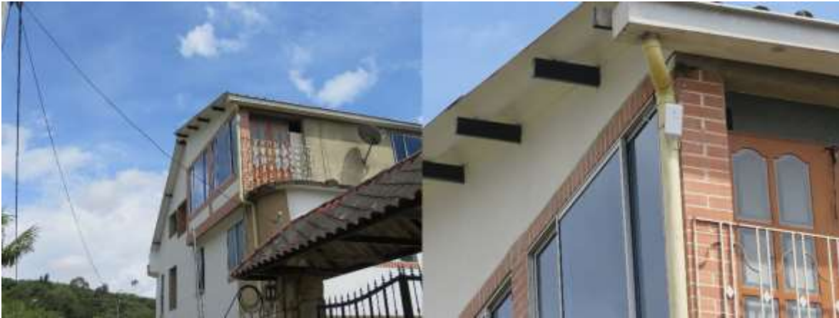
Figura N° 38: Instalación Nodo (NanoLoco) Comunidad Don Ángel (Autor).
