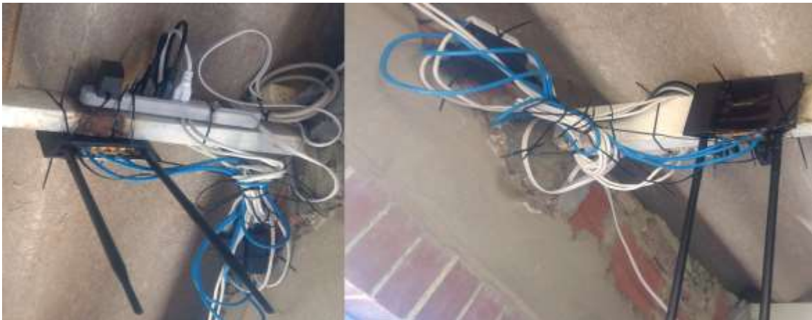
Figura N° 37: Instalación Nodo (Router) Comunidad Don Ángel (Autor).
