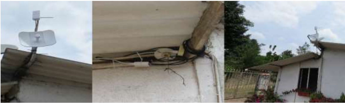
Figura N° 46: Instalación Nodo Cartodromo (Autor).
