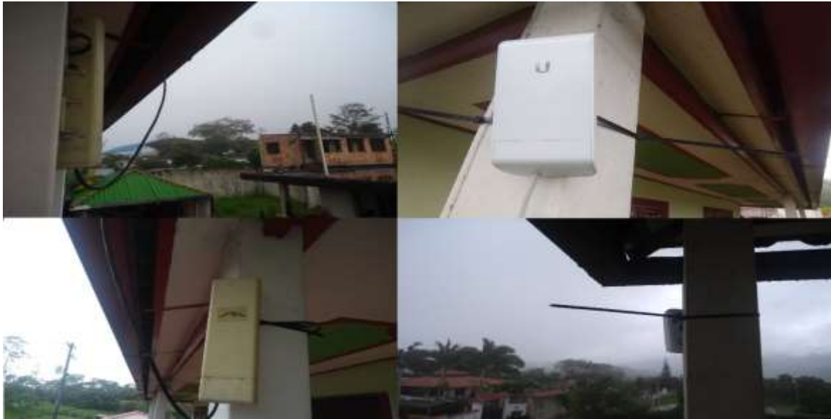
Figura N° 34: Instalación Nodos Comunidad Ángela (Autor).
