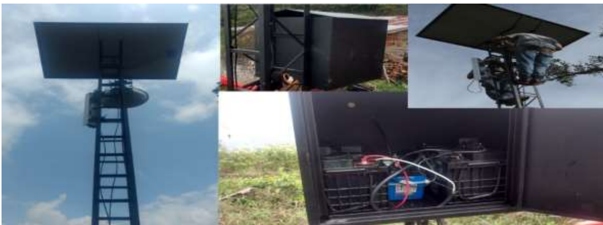
Figura N° 13: Instalación Fotovoltaica, Enlace PTP y Punto de Acceso (Antena Sectorial) (Autor).
