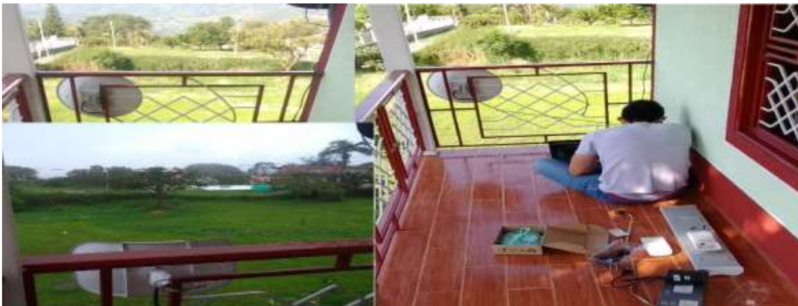
Figura N° 33: Pruebas Antena antigua, instalación antena PowerBeam AC (Autor).
