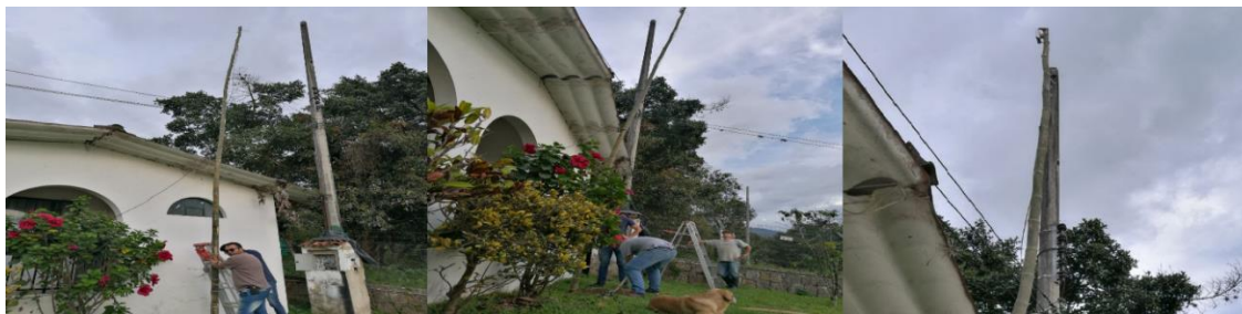
Figura N° 38: Instalación nodo Comunidad Doña Lucero (Autor).
