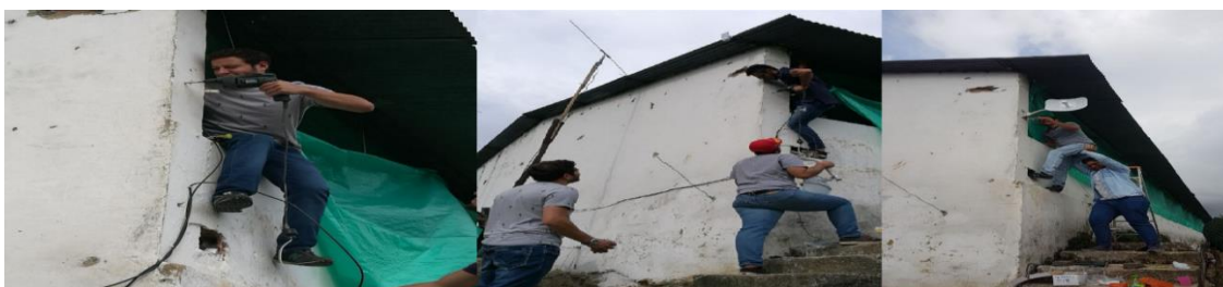
Figura N° 39: Instalación estación nodos Comunidad Doña Lucero (Autor).
