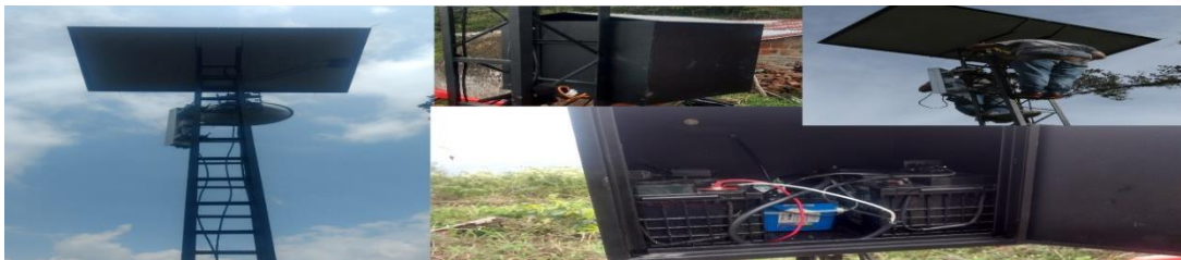
Figura N° 12: Instalación Fotovoltaica, Enlace PTP y Punto de Acceso (Antena Sectorial) (Autor).
