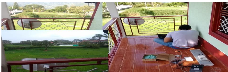
Figura N° 32: Pruebas Antena antigua, instalación antena PowerBeam AC (Autor).
