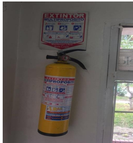
Imagen 12. Extintores (Fuente: KMELO PELUQUEROS)
