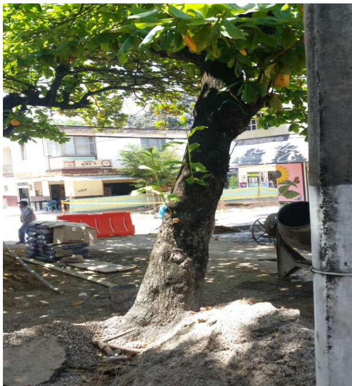
Ilustración 2. Árbol Con Raíces Expuestas Afectando Andén.
