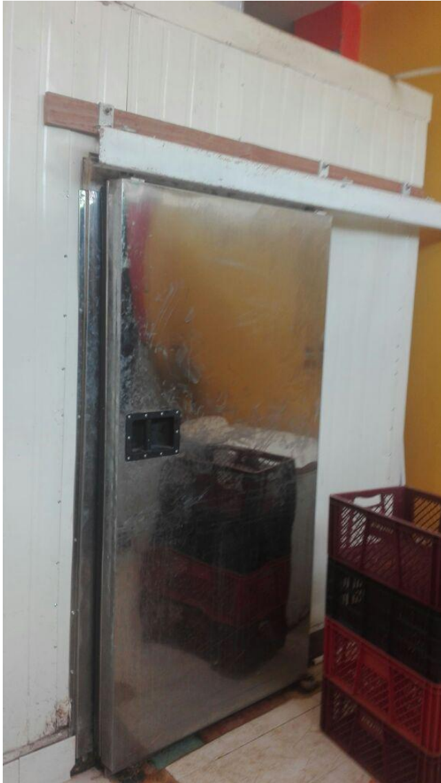
Cuarto frío con capacidad de almacenamiento de 2.000 gallinas de 3 libras maneja una temperatura no superior a los 16°C.
