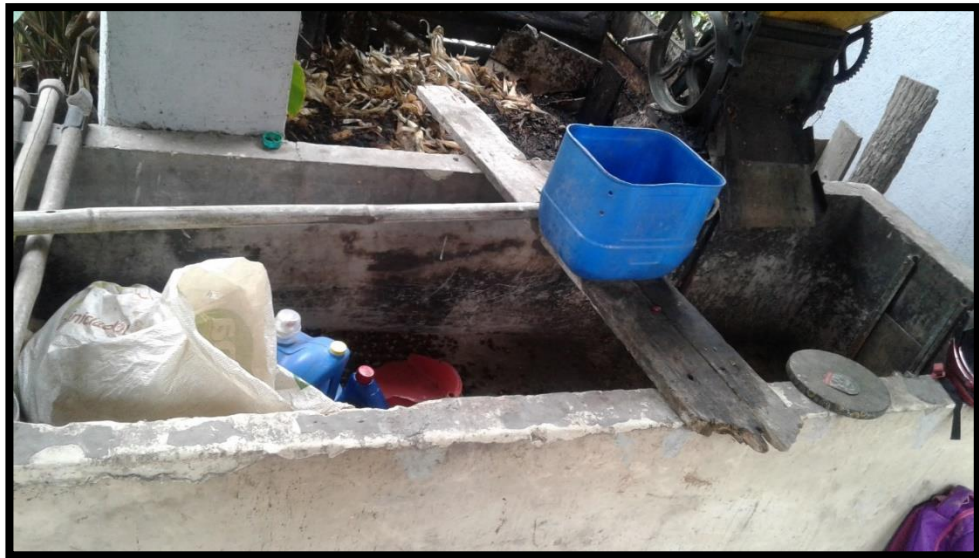
Ilustración 9 Tanque de lavado
