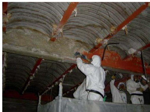
Figura A3.17 Retirada con herramienta manual (rasqueta) del recubrimiento ignífugo a base de mortero de amianto (MCA friable) en un edificio
