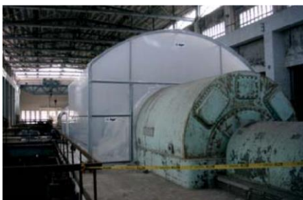
Figura A3.7a Burbuja para la retirada de los calorifugados de una turbina en una instalación industrial
