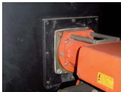
Figura A1.33 Junta en el quemador de una caldera
