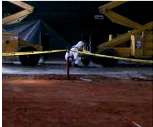
Figura A3.1 Limitación de la zona de trabajo para la retirada de una cubierta de fibrocemento
