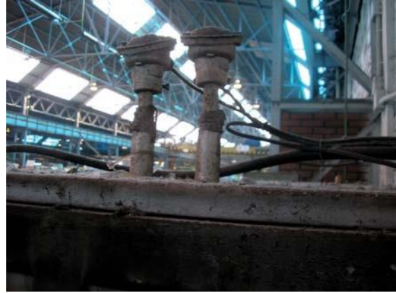
Figura A1.36 Aislamientos eléctricos en un horno
