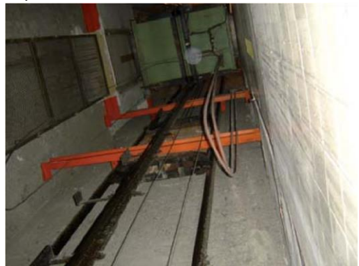
Figura A1.15 También se han encontrado aunque más raramente sobre hormigón (pared interior en el hueco de ascensor) y en la cara interna de algunas cubiertas
