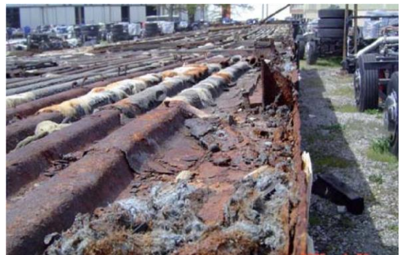
Figura A3.26a Residuos de amianto friable acondicionados para su retirada
