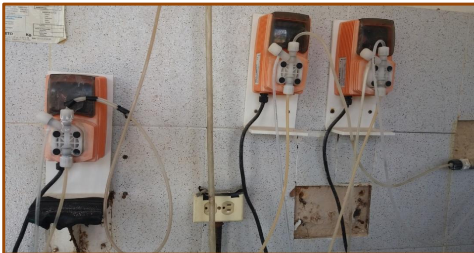
Imagen 6. Bombas dosificadoras. Fuente: Autor (Septiembre, 2016)
