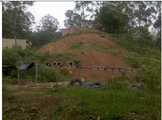
Vereda Pekín – presencia de llantas como muro de contención Tomada el 09 de Abril del 2016
