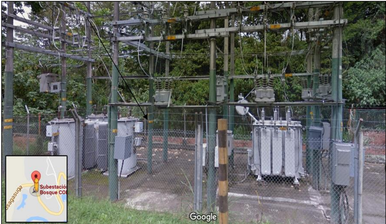
Imagen 3 Subestación el Bosque de CODENSA SA
