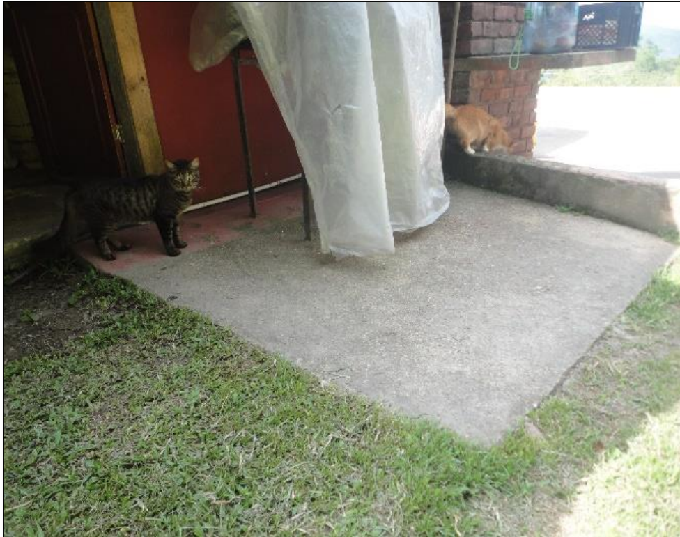
Fotografía 13. Ruta 2, Pozo séptico, Finca La Rochela, propietario: Sonia Botero
