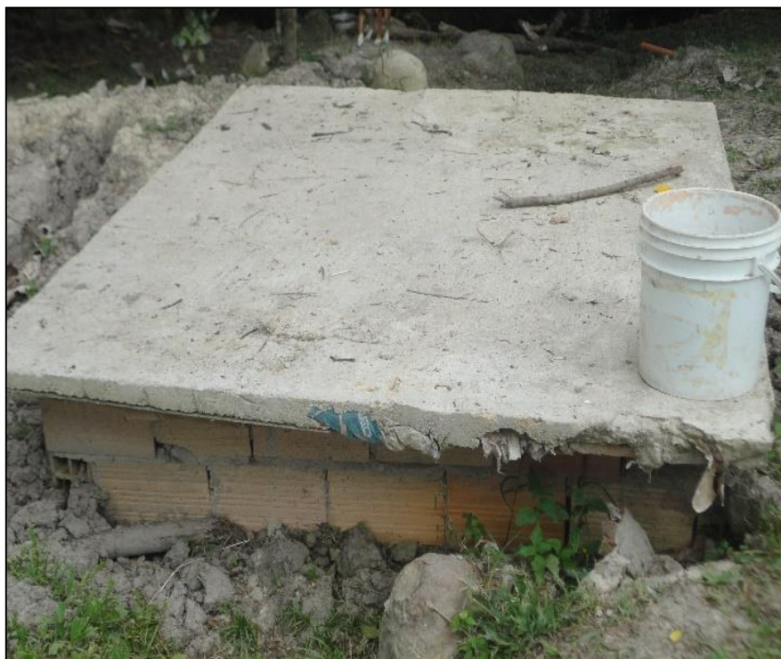
Fotografía 6. Ruta 1, Pozo séptico, finca la palma lote 11, propietario: Mariela Torres
