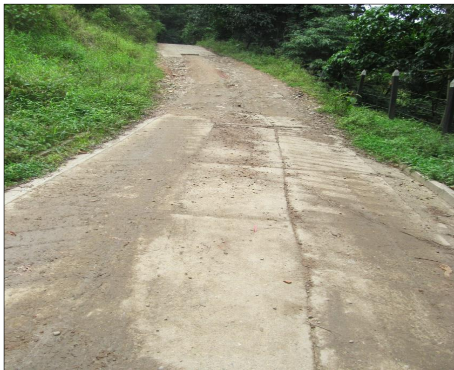
Fotografía 9 Placa huella con deterioro en la estructura (Vereda Subia) Fuente: Autores
