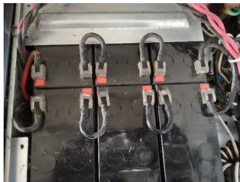
Fig. 43. Bancos de baterías de las UPS.
