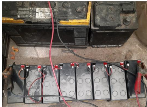
Fig. 91. Cargando las baterías para usarlas en las UPS.
