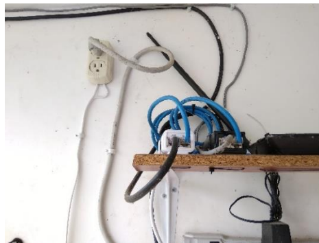
Fig. 26. Router TP link y los POE de las 2 antenas del nodo.
