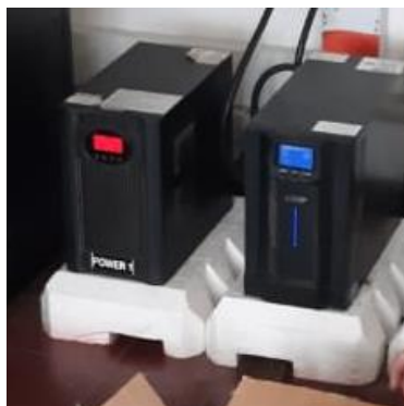
Fig. 92. UPS en funcionamiento.
