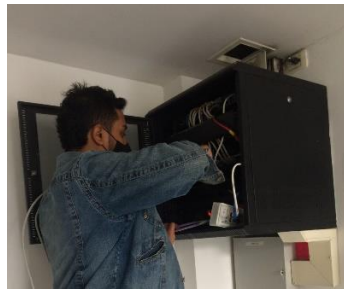
Fig. 52. Mantenimiento gabinete del despacho.
