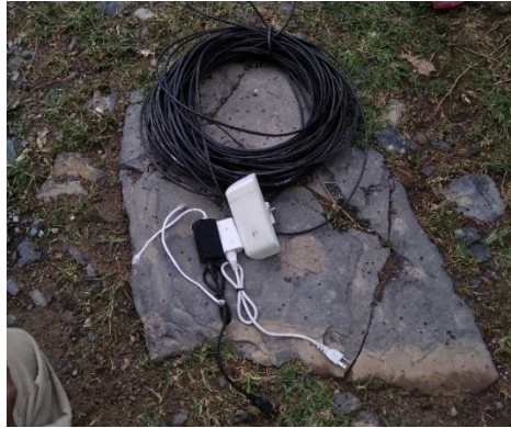
Fig. 29. Cable UTP, antena NanoStation Loco M5 y 2 POE entregados.
