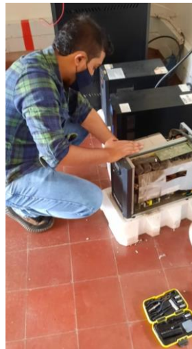
Fig. 44. Verificando el banco de baterías en las UPS.
