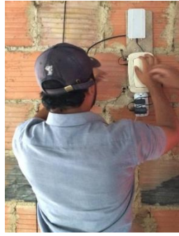
Fig. 41. Instalación del punto físico cerca a la antena NanoStation M2.
