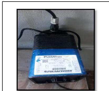
Figura. 10 Bomba dosificadora de PAC, planta Pekín. Martínez (2020).
