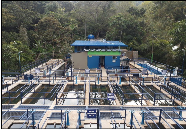
Figura. 5 Planta de tratamiento de agua potable Pekín. Martínez (2020).
