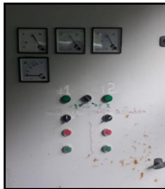
Figura. 28 Tablero de control del sistema de bombeo, planta Pekín. Martínez (2020).
