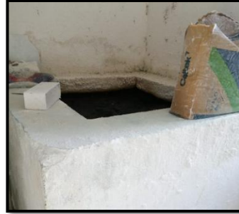
Figura. 60 Cámara de llegada al tanque de pos-alcalinización, planta Pekín. Martínez (2020).
