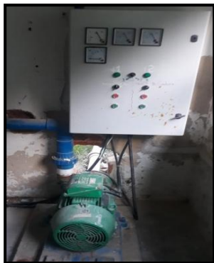
Figura. 27 Sistema de bombeo, planta Pekín. Martínez (2020).
