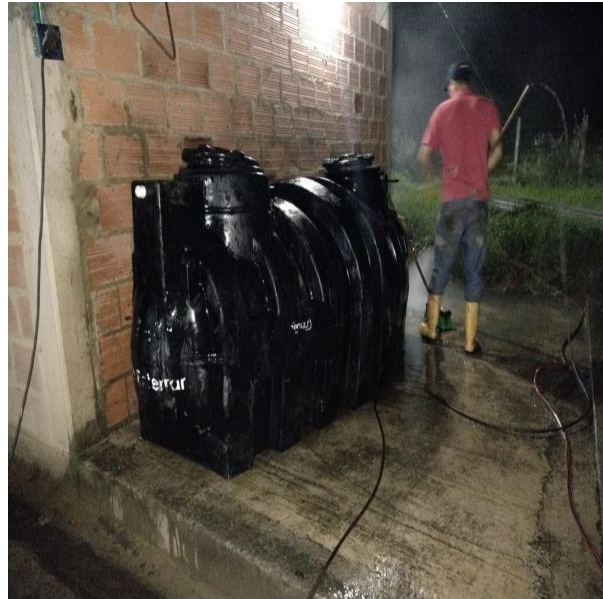
Imagen 5 Tanque de recolección lixiviados.
