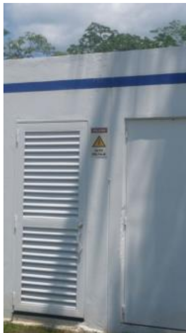
Ilustración 43 Cuarto de energía Piscina
