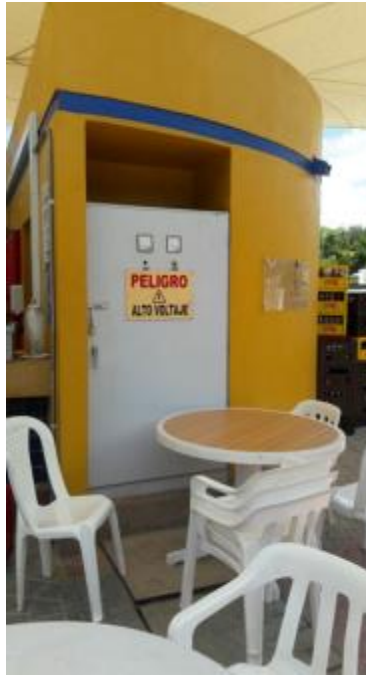
Ilustración 42 Cuarto de Energía zona comercial
