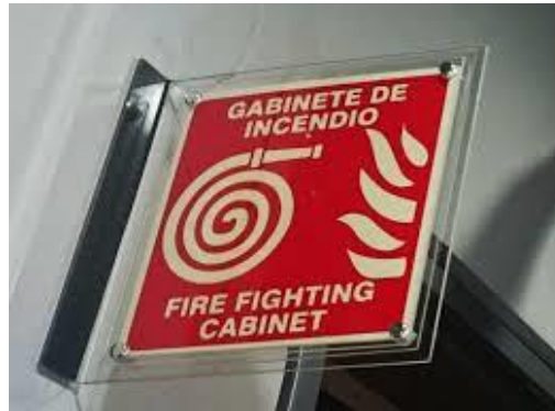
Ilustración 56 Señalización equipo contra incendios
