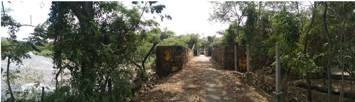
Fig. 13: Panorámica del Puente de los Suspiros sobre el Río Bogotá, Sentido Tocaima - Agua de Dios
