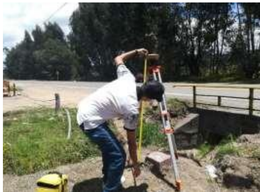
Ilustración 14:Toma de la altura del equipo- Fuente Propia
