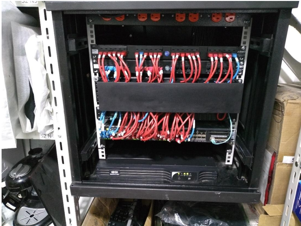
Imagen 7 Marquillaje y mapeo de Rack ubicado en almacén TI
