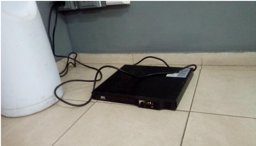
Imagen 6 UPS DataCenter Lincoln Soldaduras de Colombia
