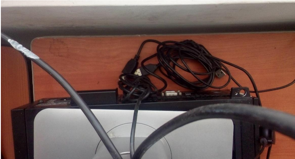
Imagen 27 Puesto de trabajo a realizar proceso arreglo de cableado, Área: Customer Care
