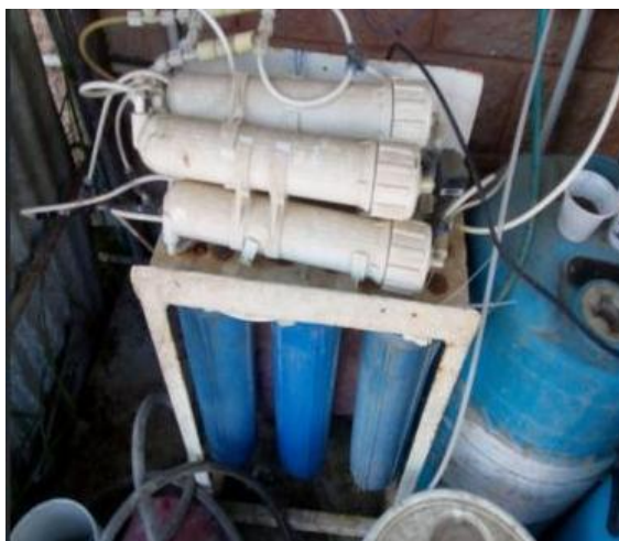
Fig. 20. Osmosis Inversa estado actual 2019, Fuente Propia
