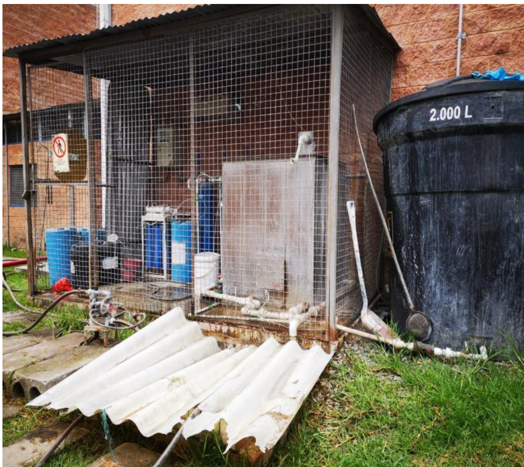
Fig. 2. PTAR Pinturas Every S.A.S, 2019, Fuente propia
