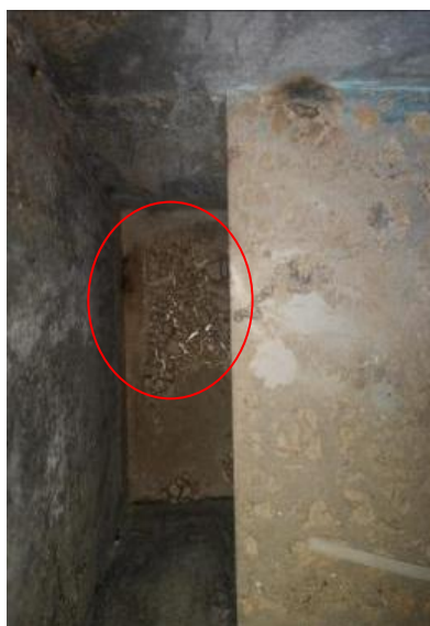
Fig. 17. Floculador vertical estado actual 2019, Fuente Propia
