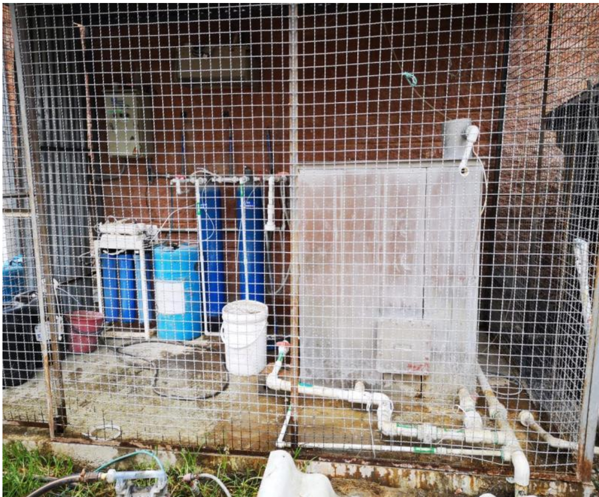
Fig. 3. PTAR Pinturas Every S.A.S, 2019, Fuente propia
