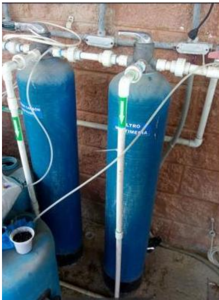
Fig. 19. Filtros de Carbón activado, arena y zeolita estado actual 2019, Fuente Propia
