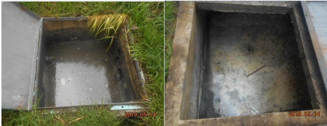
Fig. 10. Cajas de almacenamiento de aguas de lavado 2019, Fuente Propia
