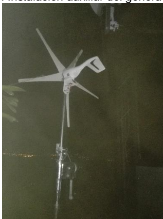
Figura 14. Instalación auxiliar del generador eólico.
