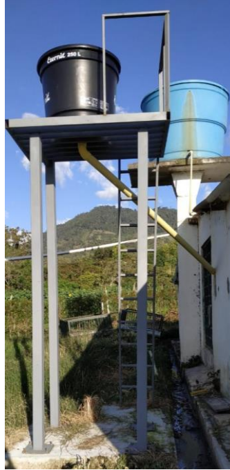
Figura 12. Estructura módulo alimentación. Almacenamiento del alimento. Elaboración propia.
