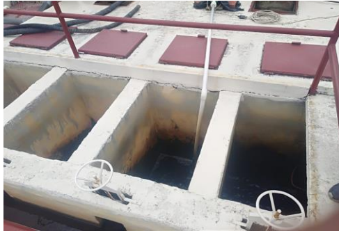
Figura N. 35 Filtración y válvulas de Lavado
