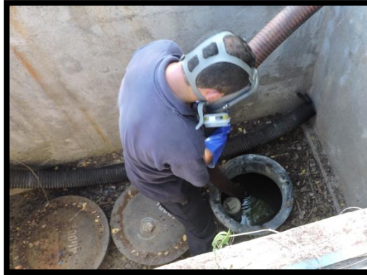
Ilustración 23 Mantenimiento pozo séptico
