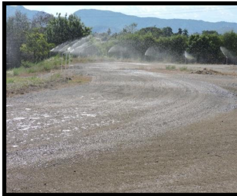
Ilustración 34 Sistema de humectación de vías
