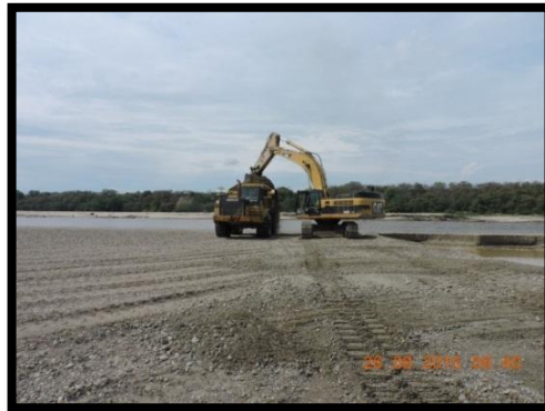
Ilustración 2 Sistema mecanizado de extracción
