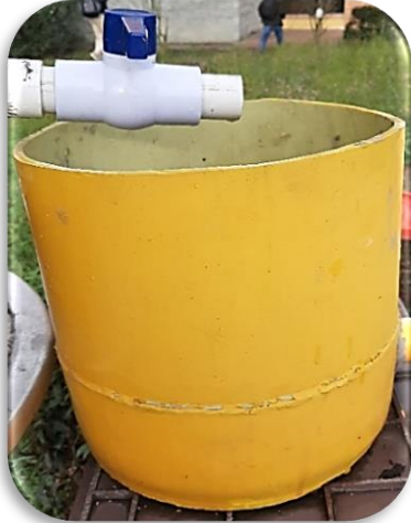
Imagen c. Trampa de sólidos o Criba.
