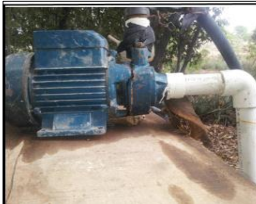
Figura 14: Motobomba para el pozo de agua gris.
