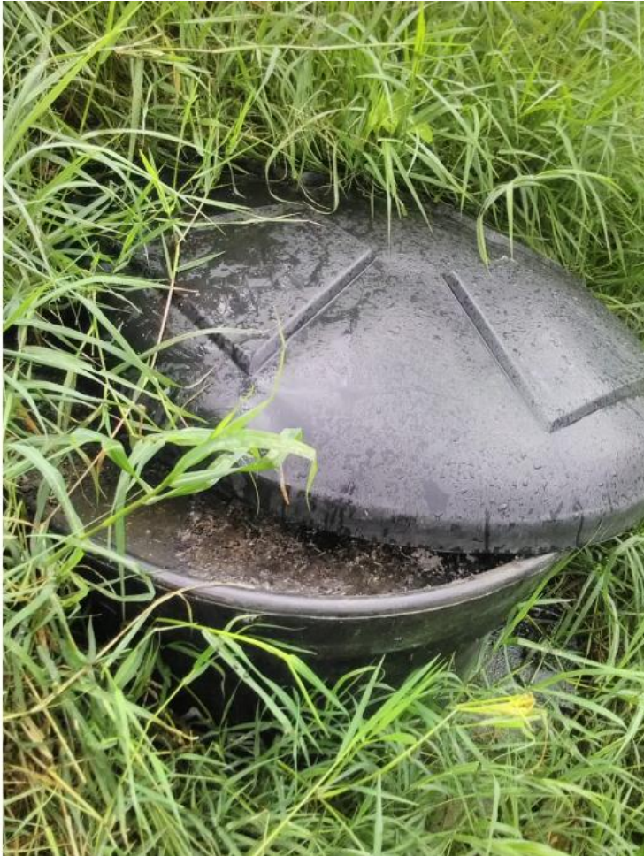
Imagen 5: tanque de almacenamiento temporal de lixiviados de la planta de compostaje.
