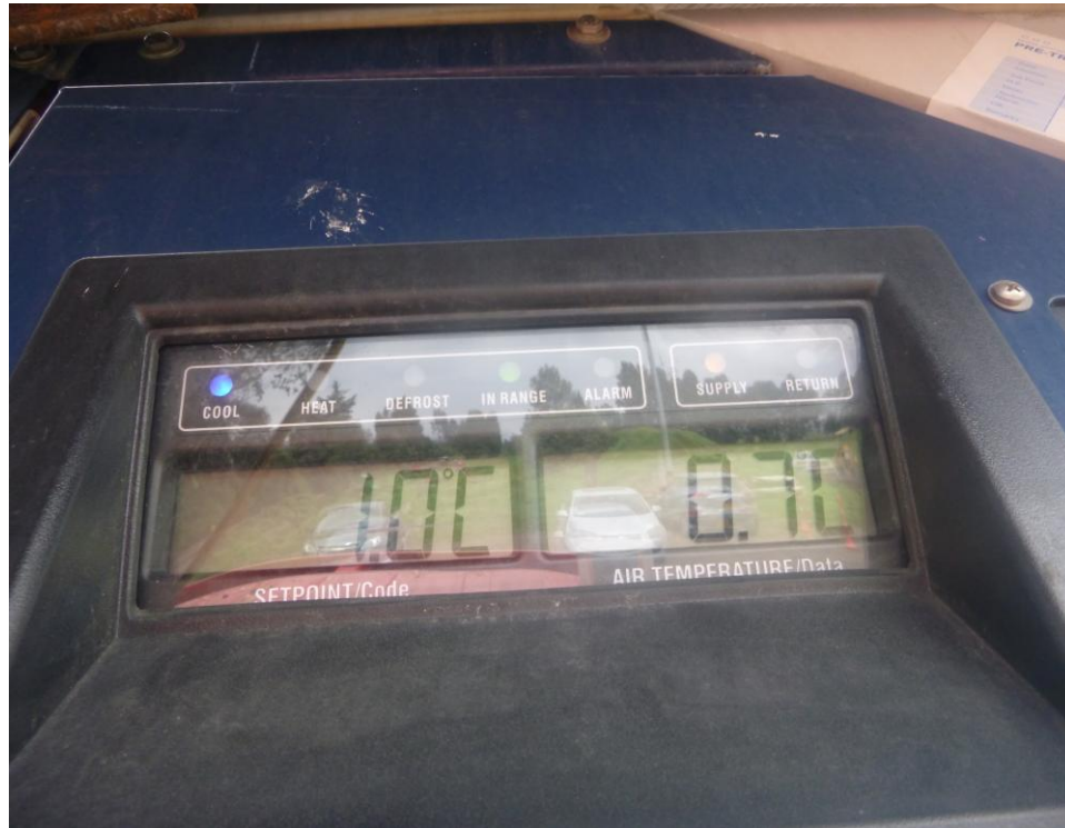
Figura 19. Verificación Genset (generador frío)
