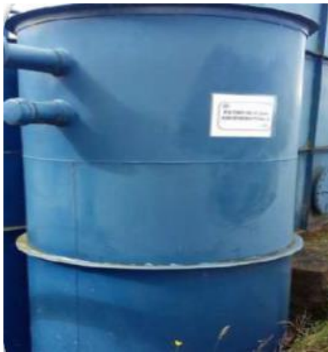
Ilustración 22. Tanque de Filtración.
