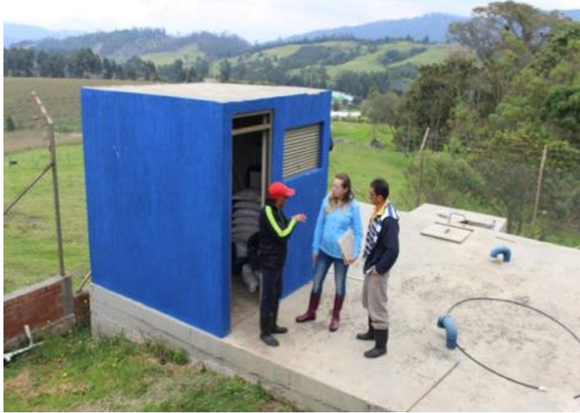
Ilustración 19. Tanque de Almacenamiento. Fuente: Autores.
