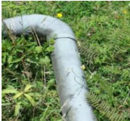
Ilustración 18. Tubería de Conducción. Fuente: Autores.
