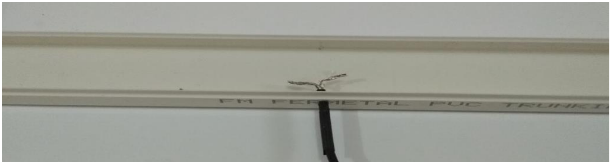
FIGURA 4. CANALETA CON CABLE MINI COAXIAL
