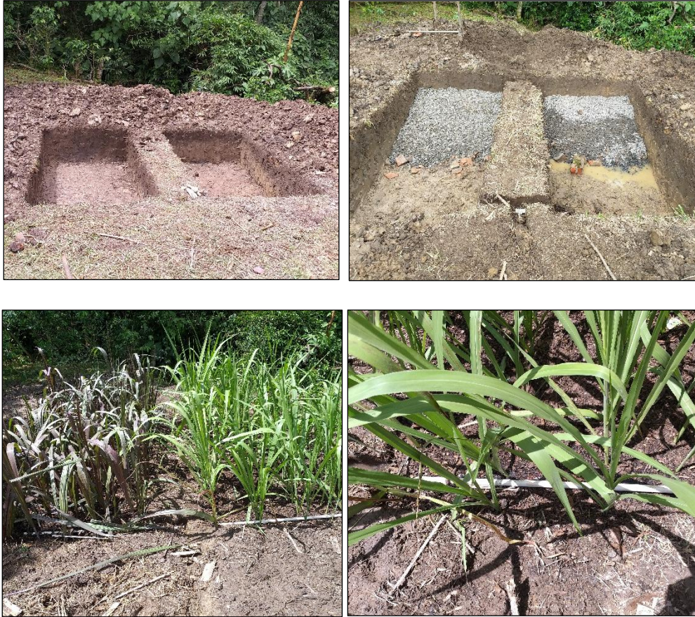
Figura 22. Arriba izquierda. Excavación de humedales de flujo horizontal. Figura 23. Arriba derecha. Manto de gravilla sobre tubería de salida de efluentes. Figura 24. Abajo izquierda Especies Fito-remediadoras: pastos Elefante ( Pennisetum purpureum ) y Guinea ( Panicum maximum ). Figura 25. Abajo derecha, Tubería de descarga: agua tratada del reactor hidrolítico
