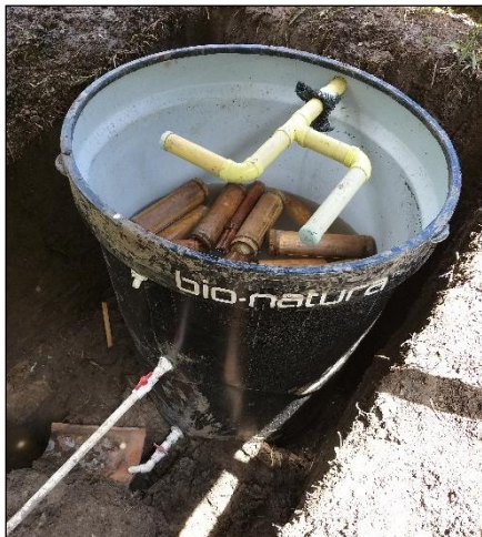
Figura 19. Izquierda. Tubería de descarga al reactor . Figura 20. Centro. Entrenudos de guadua para la reducción de la velocidad de llegada de efluentes★. Figura 21. Derecha. Salida de efluentes separados a. Agua tratada▲ b. Lodos sedimentados⊘. Fuente: (Silva, 2019).
