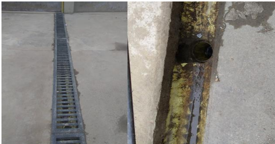
Ilustración 21 Canaletas Fuente: Autoras
