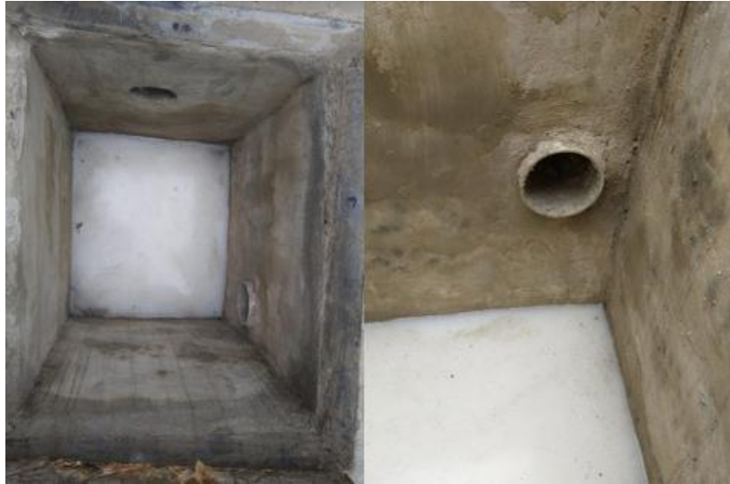
Ilustración 23 último proceso tratamiento de agua Fuente: Autoras
