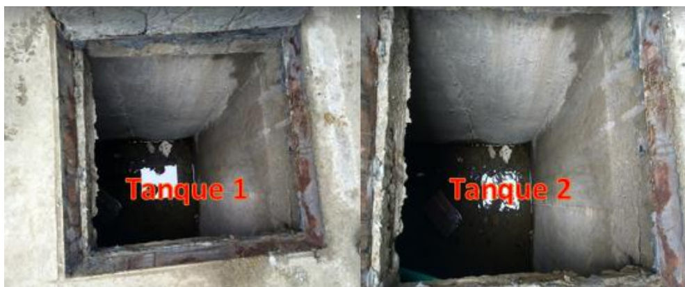
Ilustración 24 tanques almacenamiento agua Fuente: Autoras
