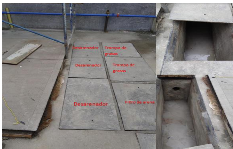
Ilustración 22 pozos tratamiento de aguas Fuente: Autoras
