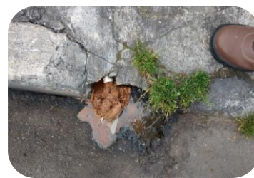
taponamiento generado por aceites vegetal
