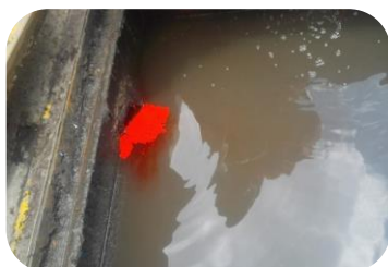
prueba con anilina identificacion de conexion errada
