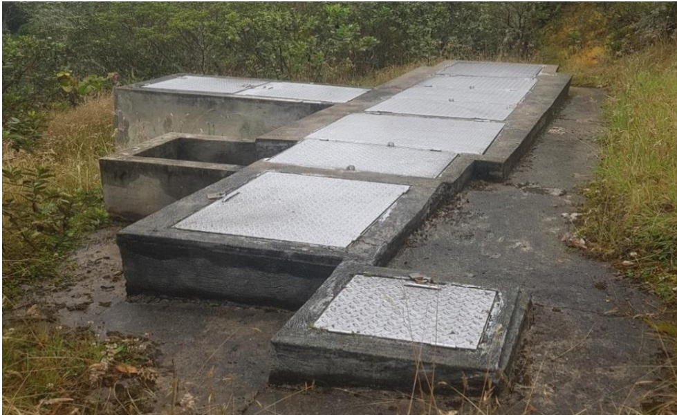
Ilustración 3. Desarenador del acueducto veredal Acuepiedraparada.
