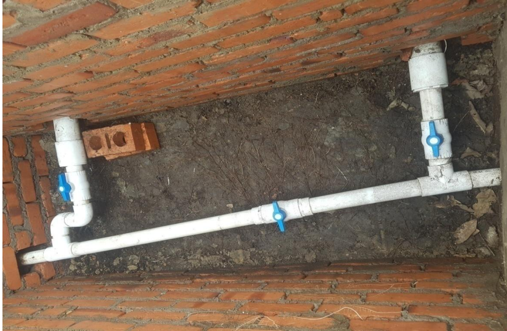
Ilustración 4. Conducción del acueducto veredal Acuepiedraparada.
