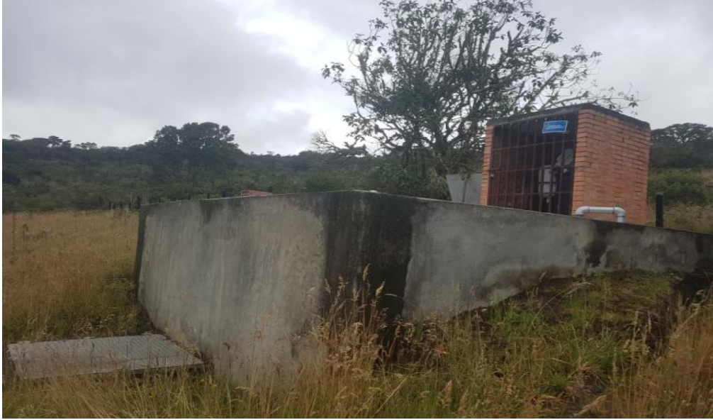
Ilustración 6. Tanque de almacenamiento del acueducto veredal Acuepiedraparada.
