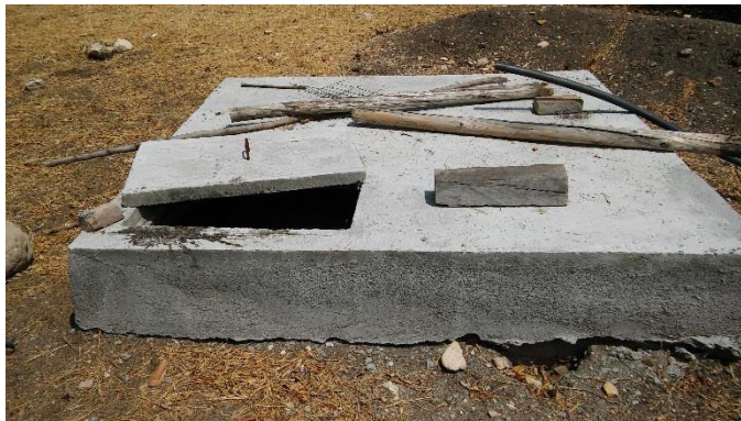
Sistema de tratamiento (Pozo Séptico)
