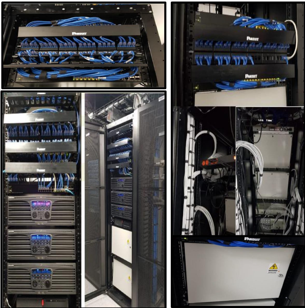
Rack de seguridad piso 3, 4 y 5 Sitel 165 en cuartos técnicos.
