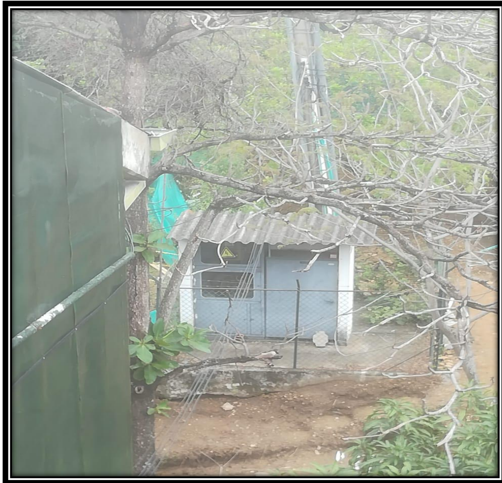
Ilustración 5. Subestación de Energías Seccional Girardot
