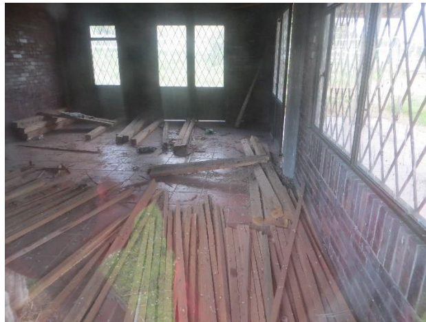
Ilustración 27 Mal estado de la infraestructura del parque Fuente: Autores
